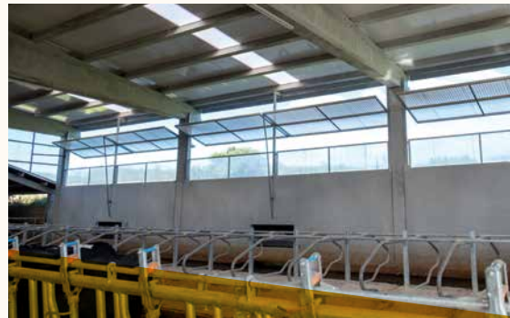
IMAGEN 32. Ejemplo de ventilación pasiva. Fuente: Calidad Pascual
